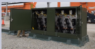
Solid Dielectric Switchgear
