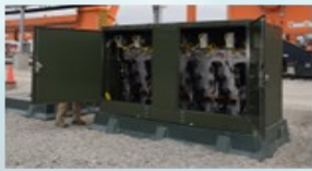
Solid Dielectric Switchgear
